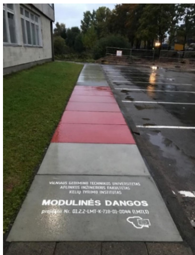
4 paveikslas. Pėsčiųjų takas su betonine moduline danga Figure 4. Pedestrian path with concrete modular coating
